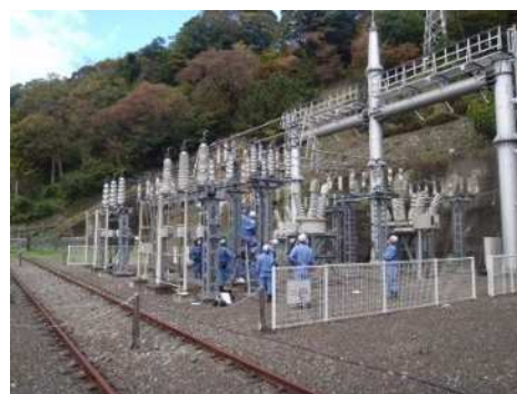
屋外開閉所 ※22 点検の様子
