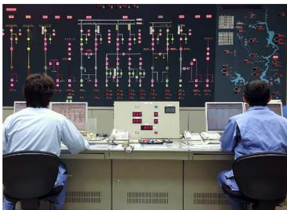
発電総合制御所（発電所の遠方監視制御）
