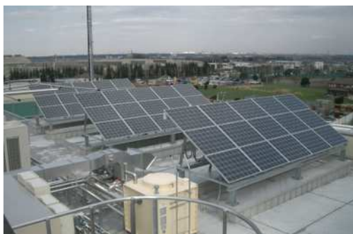
役場庁舎屋上に設置した太陽光発電設備
