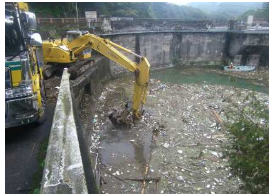
相模ダムの流芥引き揚げ状況
