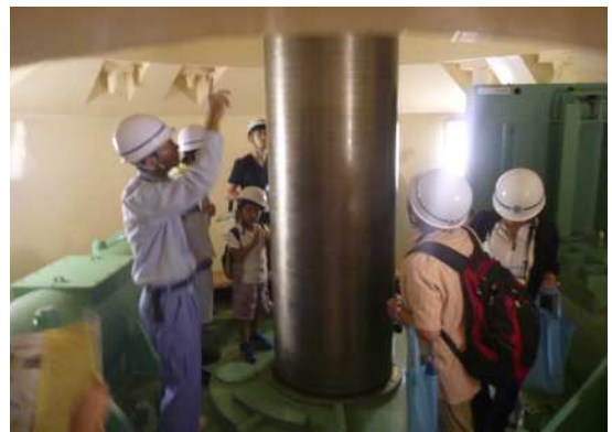
城山(発)ワクワク体験・地下発電所探検(水車発電機主軸)
