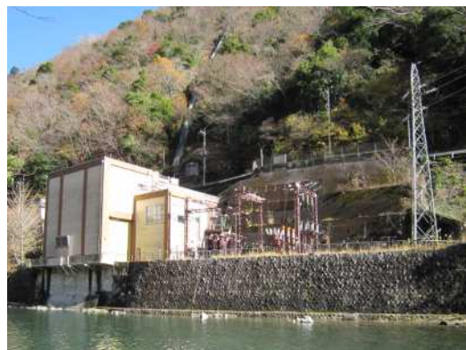
玄倉第 1 発電所
