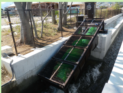
開成町小水力発電設備
