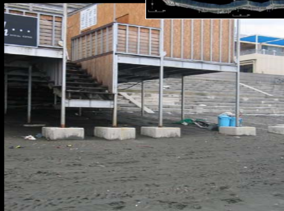
Photo 52 片瀬西浜海水浴場の仮設家屋の基礎
