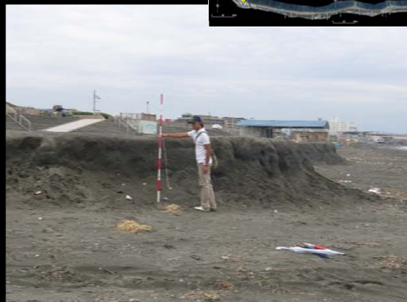
Photo 51 引地川河口の東側の養浜砂の流出状況
