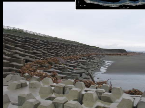
Photo 12 新設された消波工の東側隣接部に残された水位痕跡
