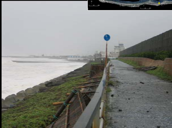
Photo 5 堆砂垣の倒壊 (16:26)
