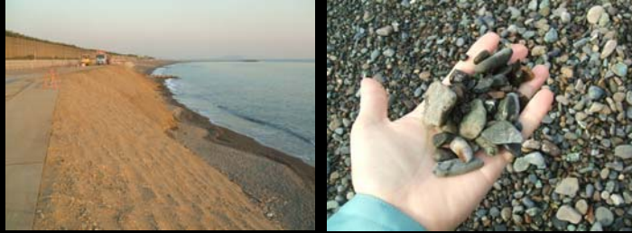
平成20年1月 養浜施工中に堆積した礫
