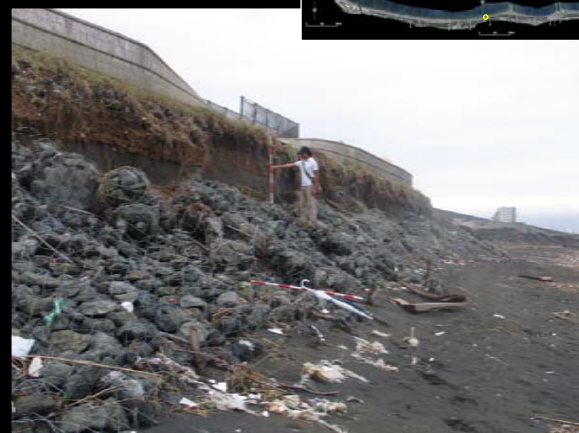
Photo 36 中詰め石が流出した蛇籠
