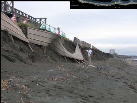
Photo 33 堆砂垣が倒壊している場所での浜岸形成
