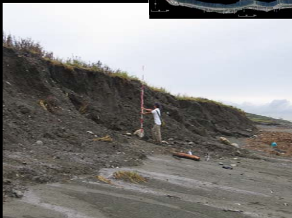
Photo 13 巻浜土砂の流出状況
