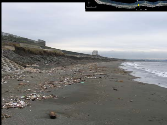
Photo 35 4号水路の東側隣接部の護岸の被災と浜岸の形成
