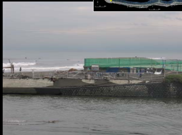
Photo 50 引地川河口左岸の転落防止フェンスの倒壊
