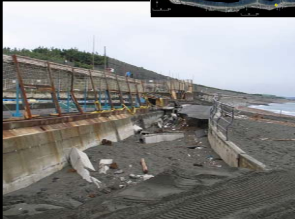
Photo 21 陥没した市営プール前の遊歩道
