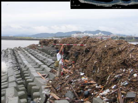
Photo 11 水制(離岸堤)に打ち上げられた浮遊物を正面から望む
