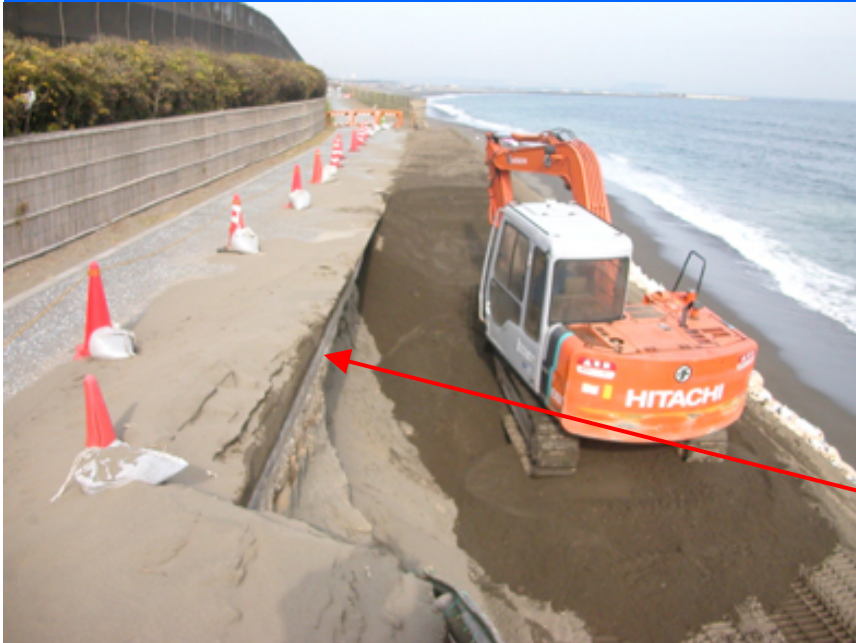
遊歩道崩落危険状況
