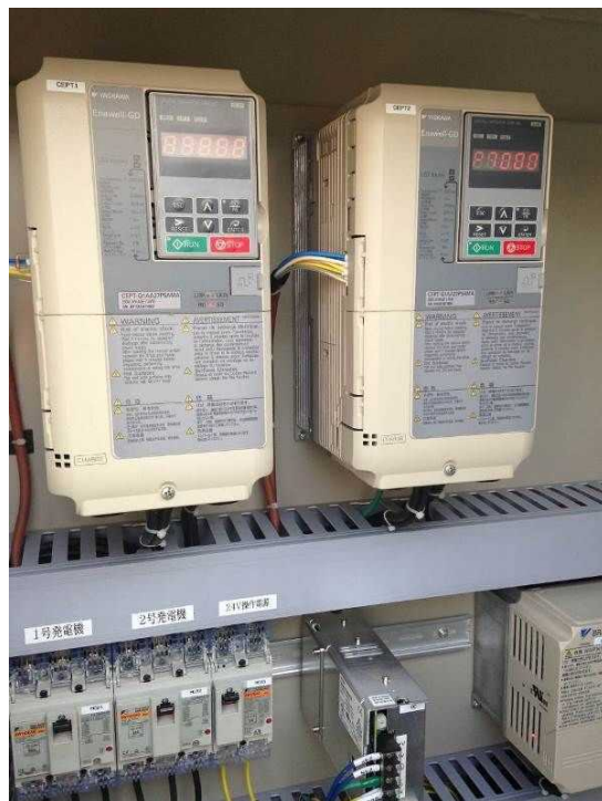
制御設備の表示確認
