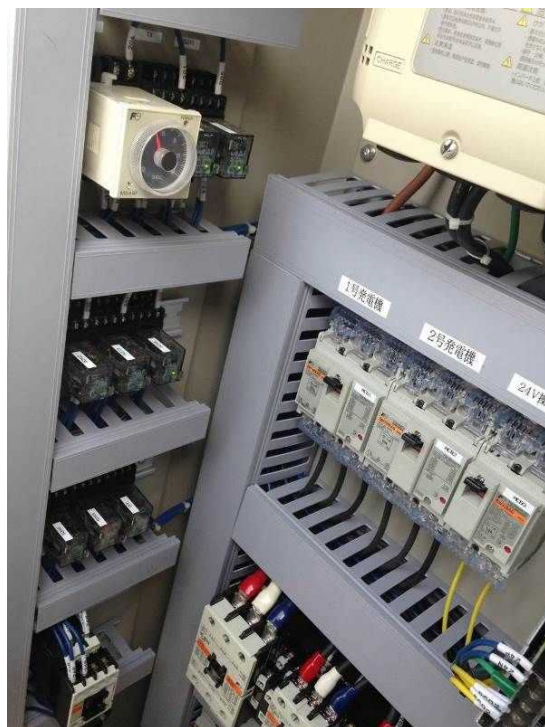
制御設備内の結露・ほこり等の確認
