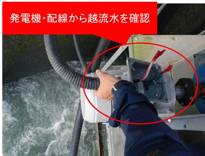
図-2.12 施工不良の配管差込部
