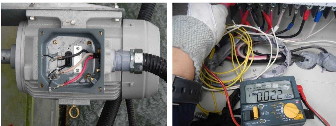
図-2.14 2013/9/25の水位上昇により発生した発電機内部への入水状況
