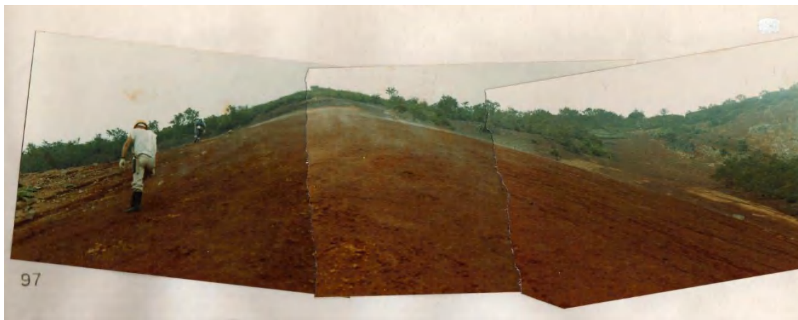
昭和58年 荒廃状況（三ノ塔）
