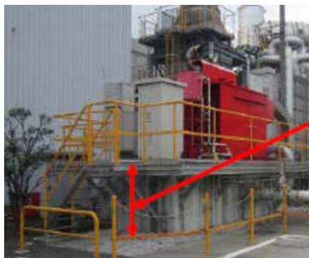
防消火設備（消防ポンプ）
