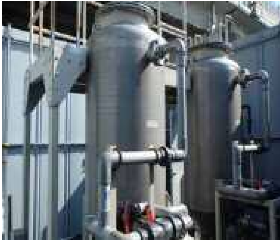
地下水汚染対策（秦野市 浄化施設）
