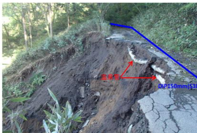
令和元年台風19号による管路の被害状況
