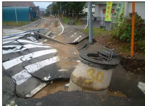
(マンホールの突出)
