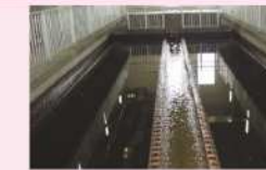
7 最終沈殿池 最終沈殿池で水をゆっくり流すと、糞のようなかたまりとなった活性汚泥が池の底に沈み、水はすっかりきれいになります。一方、沈んだかたまりの一部は反応タンクへもどされ、再び下水の浄化に利用されます。なお、余った活性汚泥は余剰汚泥といい、汚泥濃縮設備へ送られます。
