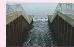
9 放流口 きれいになった水が、きれいにより川や海へ放流されます。
