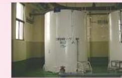
8 消毒施設 きれいになった水を消毒します。
