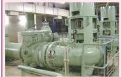
4 ポンプ室 地下深く流れてきた下水を水処理施設に送るため、必要な高さまでくみ上げます。
