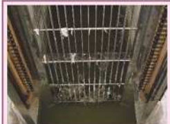
3 沈砂池 下水管から流入してきた下水に含まれる大きなゴミや土砂などを取り除き、ポンプのつまりや磨耗を防ぎます。
