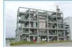
10 汚泥焼却炉 有機物を含んだ脱水汚泥をこの焼却炉で燃やすと灰になり、減量されます。
