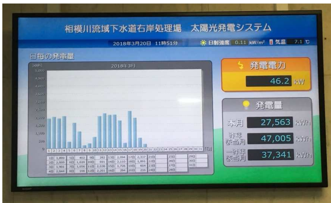
管理棟に設置したデジタル表示
