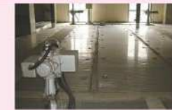
5 最初沈殿池 沈砂池からの下水をさらにゆっくり流して、細かい汚れを沈殿させ、水面に浮かんだスカム（油や野菜くず）を取り除きます。これで水はかなりきれいになります。沈殿した汚泥は汚泥濃縮設備へ送られます。
