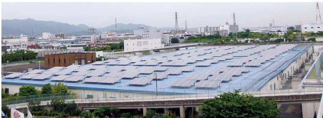
太陽光発電設備
