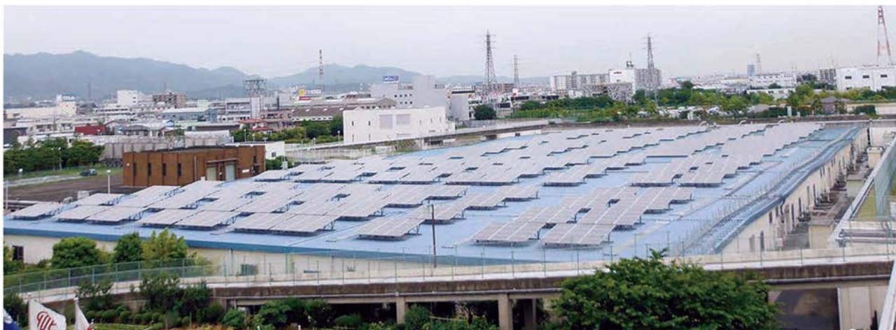
太陽光発電設備
