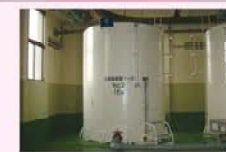
⑧ 消毒施設 きれいになった水を消毒します。
