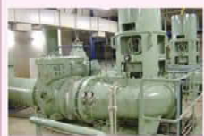
④ ポンプ室 地下深く流れてきた下水を水処理施設に送るため、必要の高さまでくみ上げます。
