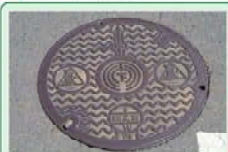
① マンホール 下水管の点検や清掃をするための入口です。
