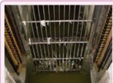
③ 沈砂池 下水管から流入してきた下水に含まれる大きなゴミや土砂などを取り除き、ポンプのつまりや腐敗を防ぎます。
