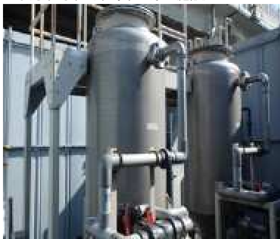
地下水汚染対策(秦野市 浄化施設)
