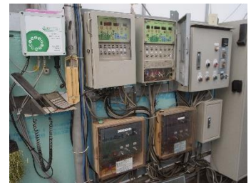
複合環境制御盤
