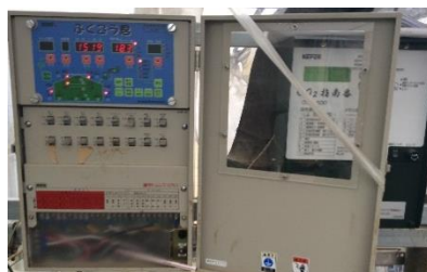
制御盤・コントローラー（制御は個別）
