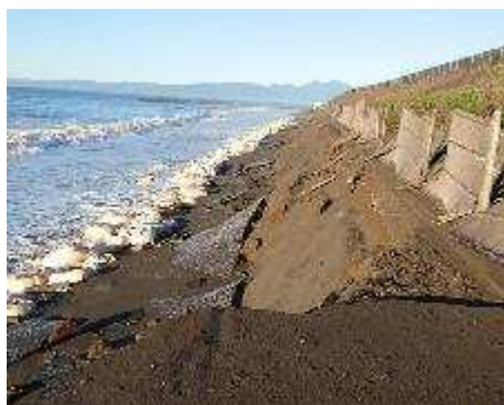
令和元年台風第 19 号における被害状況 (茅ヶ崎海岸)
