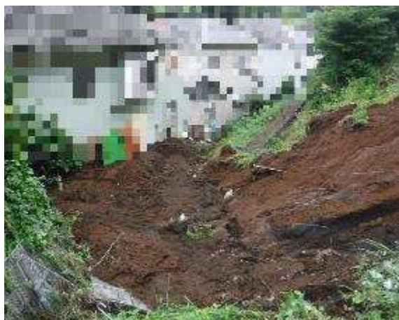
がけ崩れ発生状況
