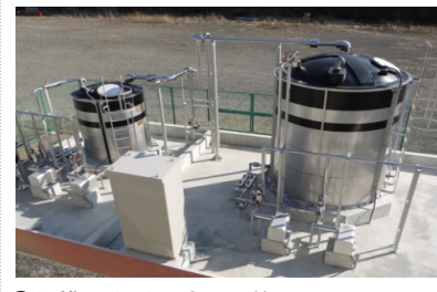
③相模川水系上流域対策 山梨県内の下水処理場に新たに設置したリンを取り除くための設備を稼動した。(山梨県 桂川清流センター)
