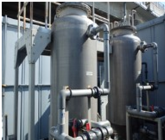
地下水汚染対策（秦野市 浄化施設）
