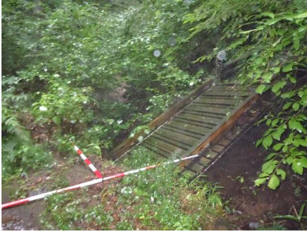
N7崩落した木橋
