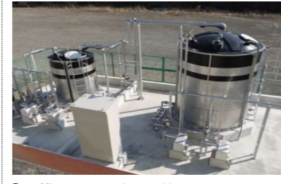
③相模川水系上流域対策 山梨県内の下水処理場に新たに設置したリンを取り除くための設備を稼動した。（山梨県桂川清流センター）
