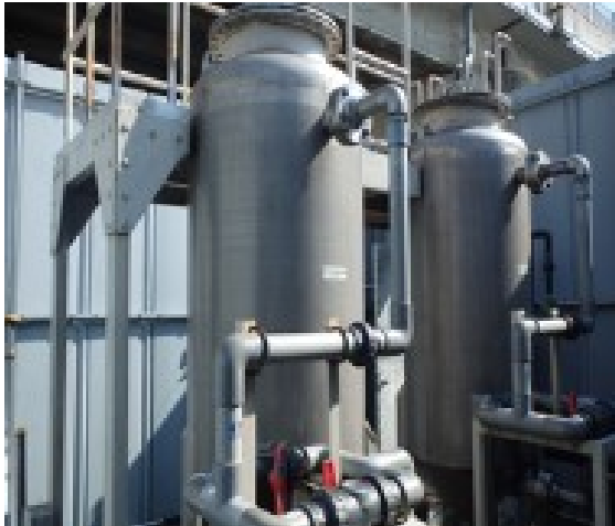
地下水汚染対策(秦野市 浄化施設)
