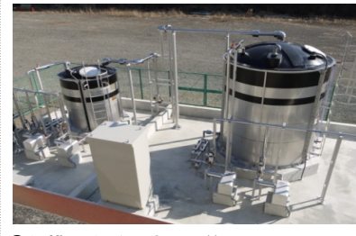
③相模川水系上流域対策 山梨県内の下水処理場に新たに設置したリンを取り除くための設備を稼動した。（山梨県桂川清流センター）
