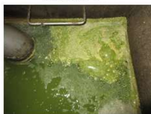
排水槽内浮遊物
