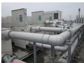
屋上既設チラー
