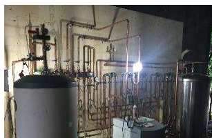
クラフトワークシステム / VEMS (Various Energy Management System)
