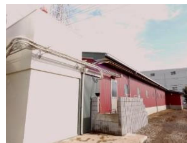
豚舎（奥）と脱臭装置（手前）
