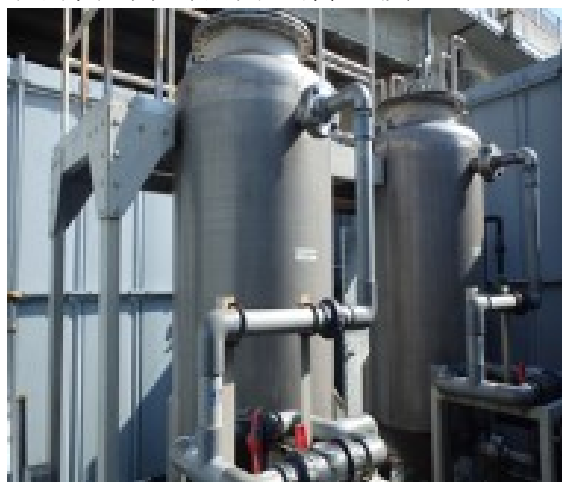
地下水汚染対策（秦野市 浄化施設）
