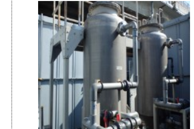
⑦地下水保全対策 有機塩素系化学物質で汚染された地下水を施設の装置に通すことにより水質浄化を図った。(秦野市)
