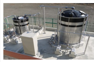
③相模川水系上流域対策 山梨県内の下水処理場に設置したリンを取り除くための設備を稼動した。(山梨県桂川清流センター)
