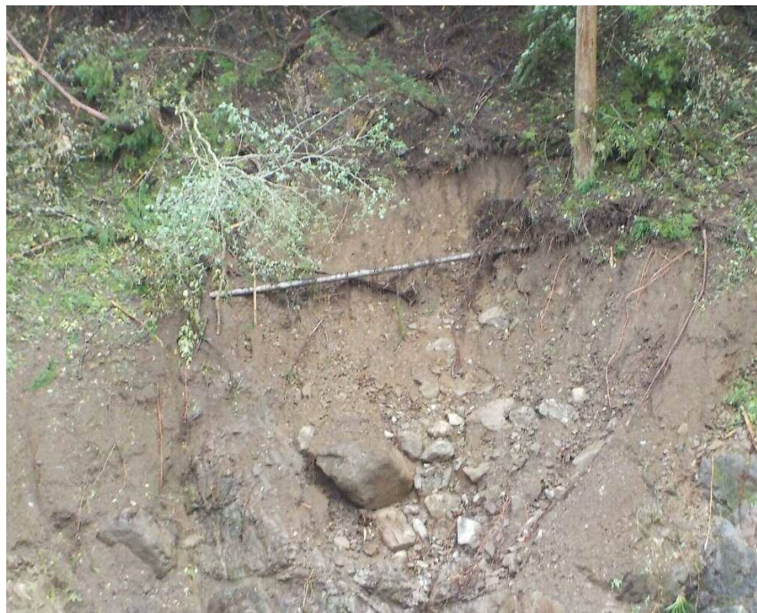
斜面崩落による導水管破損 (長野浄水場)
