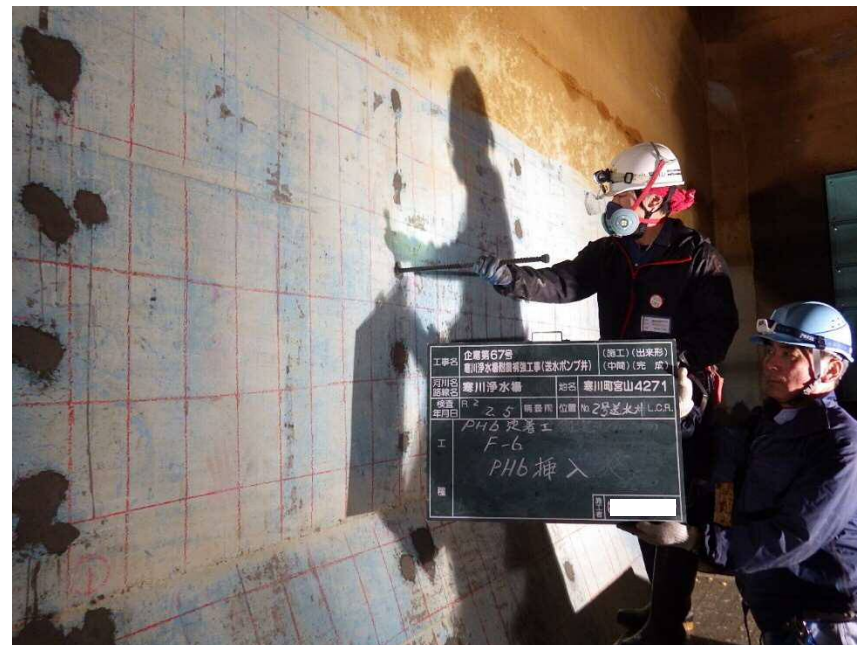
寒川浄水場送水ポンプ井の躯体に鉄筋を挿入して補強している様子 (寒川第3浄水場は令和元年度で耐震化完了)
