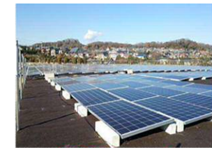
湘南ベルマーレ 谷ヶ原太陽光発電所
