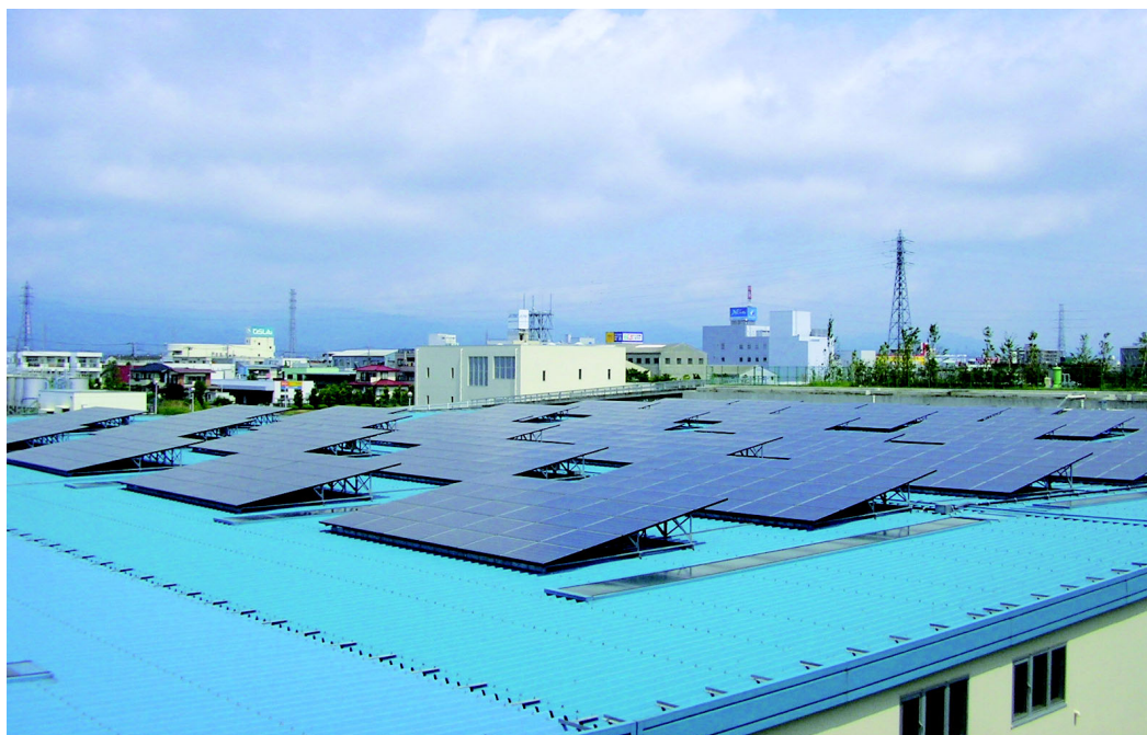
相模川流域下水道四之宮水再生センター 太陽光発電設備
