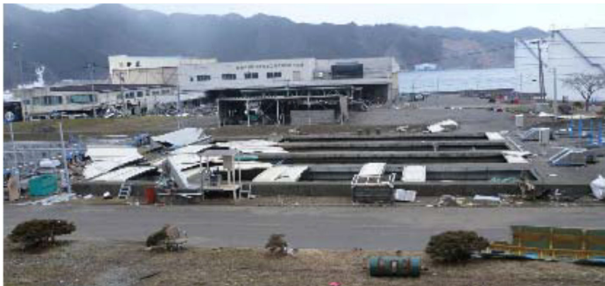
下水処理場の水処理施設の被害状況 (宮城県釜石市 大平下水処理場)
