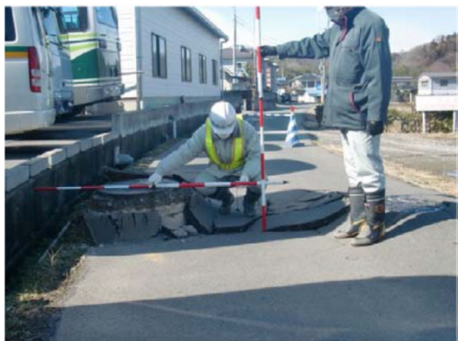
液状化による管渠施設の被害状況 (栃木県 真岡市)
