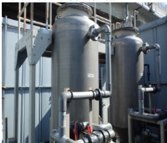
地下水汚染対策（秦野市 浄化施設）
