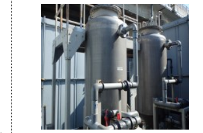
⑦地下水保全対策 有機塩素系化学物質により汚染された地下水を施設の装置に通すことにより水質浄化を図った。(秦野市)
