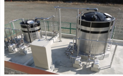
③相模川水系上流域対策 山梨県内の下水処理場に新たに設置したリンを取り除くための設備を稼動した。(山梨県 桂川清流センター)
