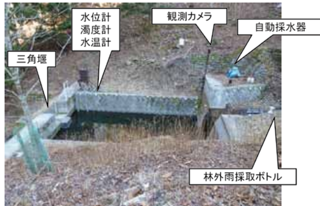
大洞沢No.4 量水堰の周辺の観測機材 自然環境保全センター撮影（H 23）
