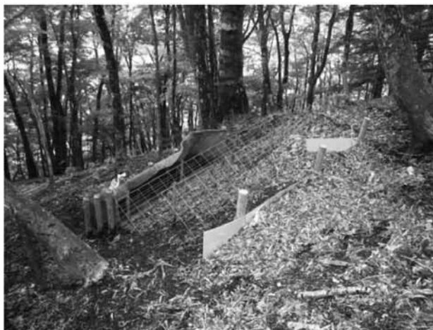
写真6 リター捕捉金網工
