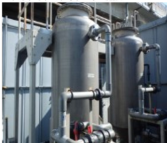
地下水汚染対策（秦野市 浄化施設）
