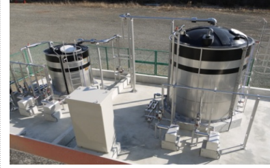
③相模川水系上流域対策 山梨県内の下水処理場に新たに設置したリンを取り除くための設備を稼動した。(山梨県 桂川清流センター)
