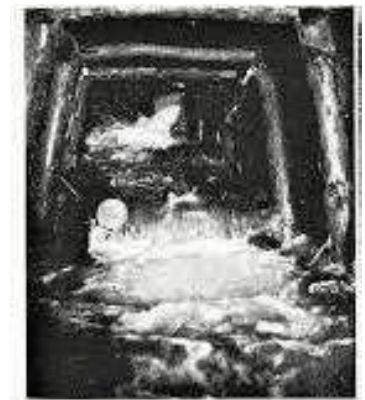
丹那トンネルの湧水状況 出典) 鉄道80年のあゆみ 1872-1952、 運輸調査局(編)、日本国有鉄道
