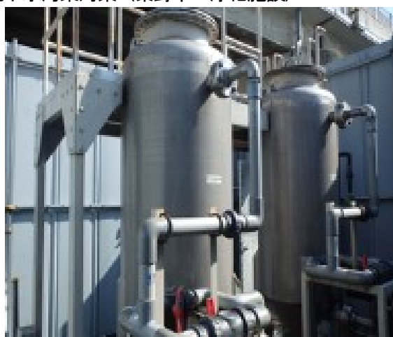
地下水汚染対策（秦野市 浄化施設）
