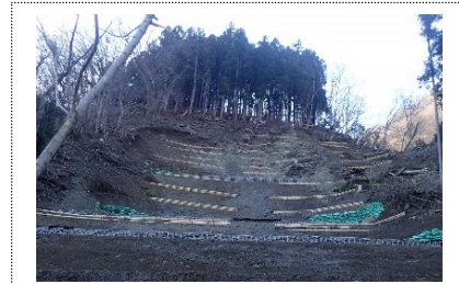
③土壌保全対策 水源林の基盤整備では土木的工法を用いて土壌保全対策を実施した。(山北町世附)
