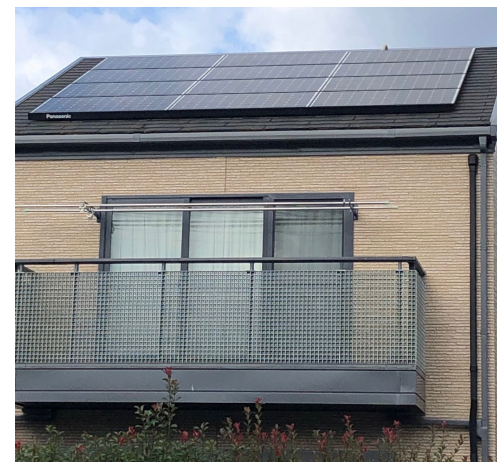
太陽光発電の設置事例
