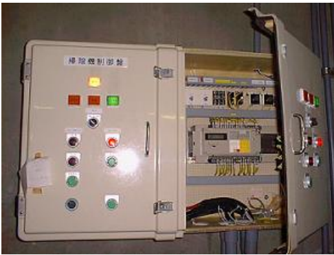
底掃除機制御盤
