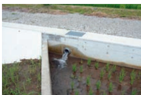
⑧パイプの入口(大井町)
