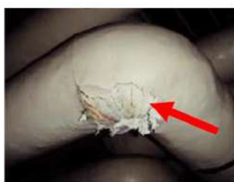
レベル2の石綿含有建材 （保温材）
