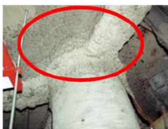
レベル1の石綿含有建材 （吹付け石綿）
