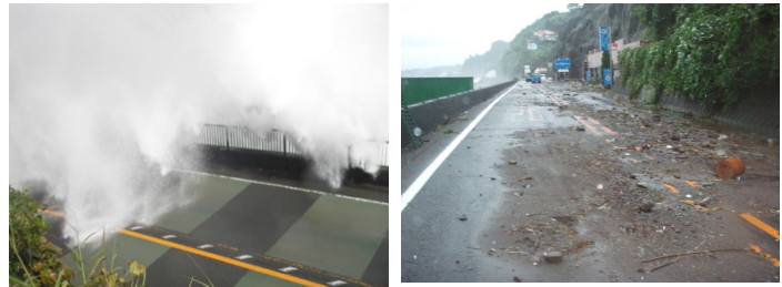
平成19年台風9号による越波被災状況
