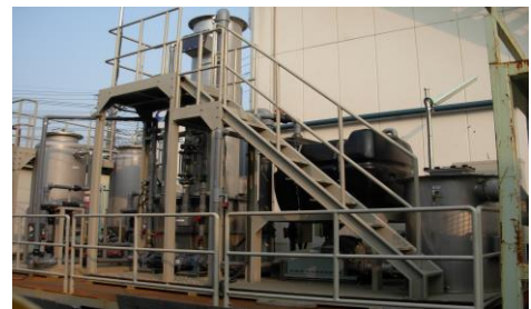
地下水浄化設備(秦野市)
