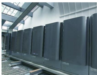
(横浜市燃料電池システム) 出典：横浜市パンフレット
