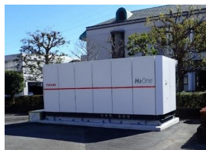
(県企業庁の水素エネルギー供給設備)
