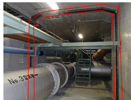
水処理施設の耐震対策(エキスパンションジョイント)
