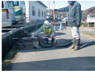
液状化による管きょ施設の被害状況 (栃木県 真岡市)
