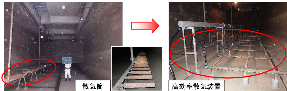
図 16 省エネ型高効率散気装置（酒匂川流域下水道 酒匂水再生センターの水処理施設）
