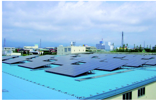
図 15 相模川流域下水道四之宮水再生センター 太陽光発電設備
