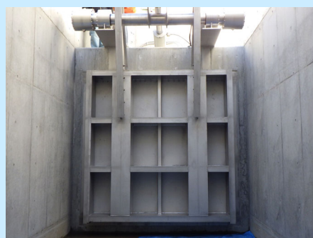
図 津波逆流防止ゲート
