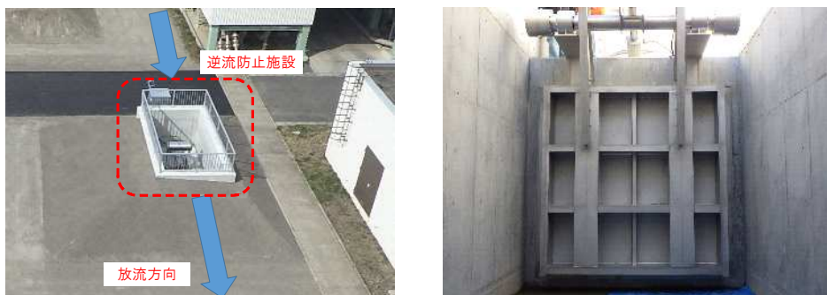
【施設の耐震化】津波逆流防止ゲート（柳島水再生センター） (津波逆流防止施設) (津波逆流防止ゲート)
