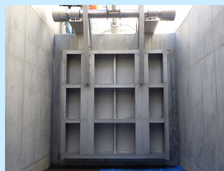
図 津波逆流防止ゲート (参考：令和3年度完成例)
