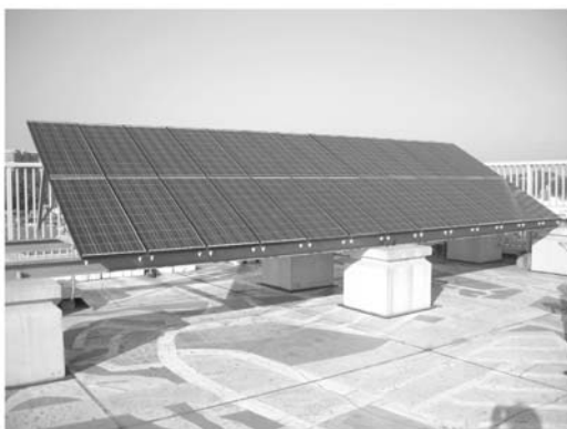
大矢部小学校の校舎に設置されたソーラーパネル
