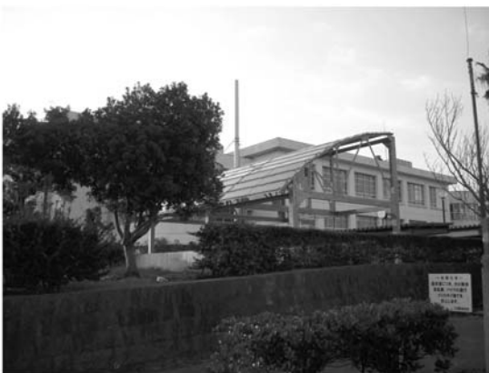
三浦臨海高等学校に設置したソーラーパネル
