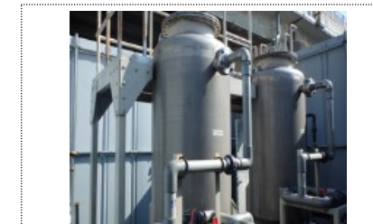
⑦地下水保全対策 有機塩素系化学物質で汚染された地下水を施設の装置に通すことにより水質浄化を図った。(秦野市)
