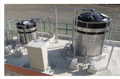
⑨相模川水系上流域対策 山梨県内の下水処理場に設置したリンを取り除くための設備を稼動した。(山梨県桂川清流センター)
